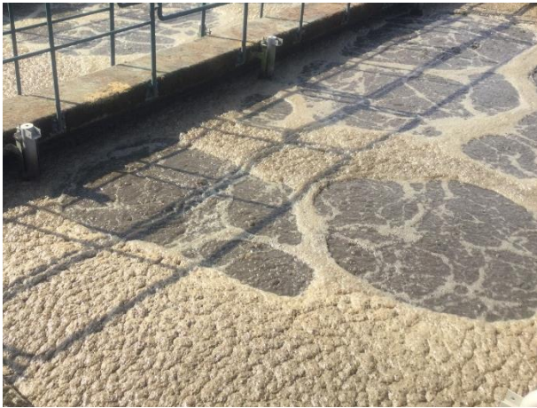
Voorbeeld lichte vorm van fijne bellenbeluchting, met schuimvorming
