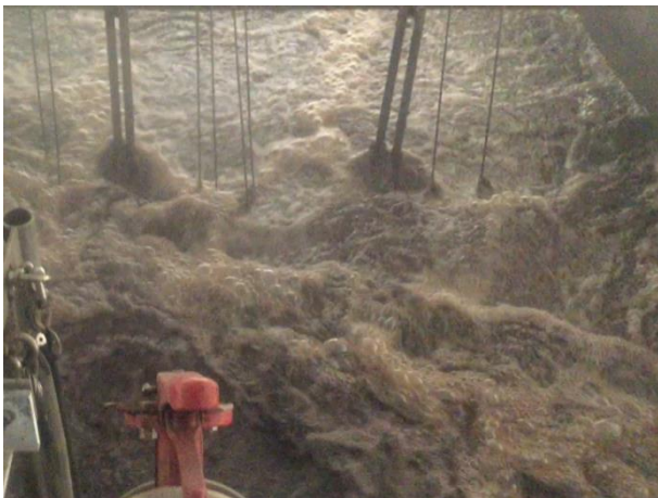
Voorbeeld grove bellenbeluchting, mede om membranen schoon te houden
