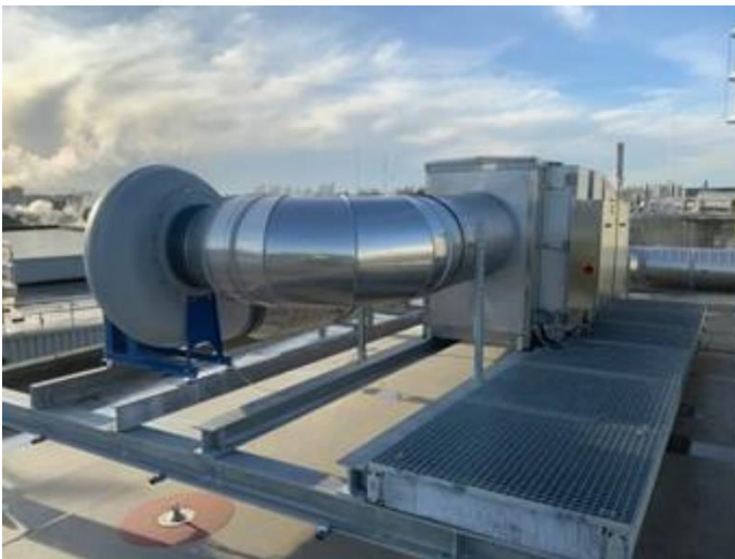
Voorbeeld AWZI Boxtel: luchtafzuiging met luchtfilters en UVc-behandeling.
